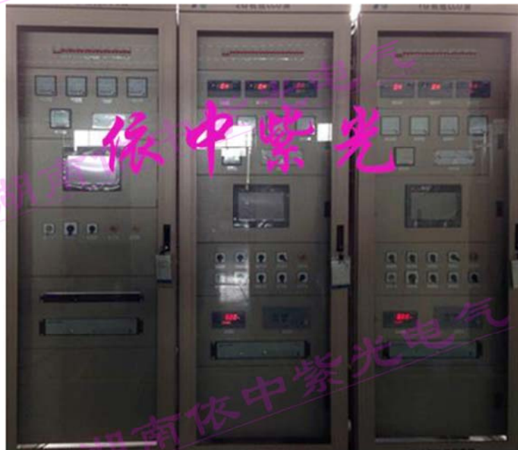
火力发电综合自动化实验系统
